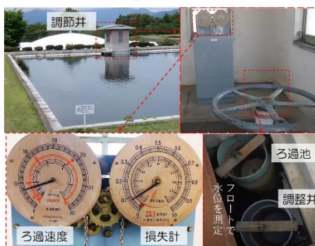
図13 調節弁の損失と流量は機械的に計測
