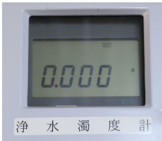
図38 染屋浄水場のろ過水濁度は常に0.000度
