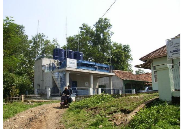
図13 村の浄水プラント
