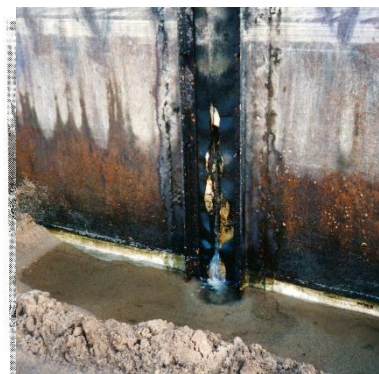
図23 垂直壁のパッキング部から漏水
