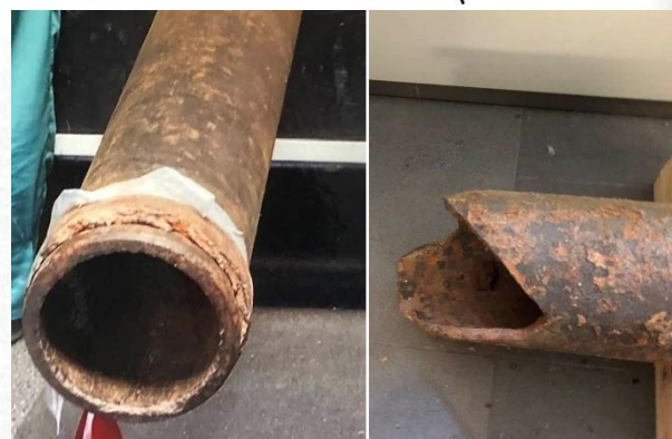
図5 明治から使っていた給水管
