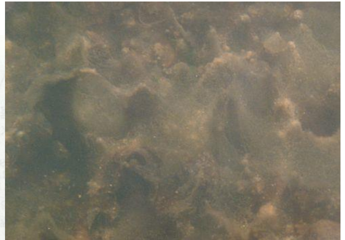
図28 正常のろ過池砂面
