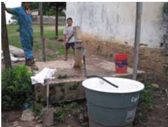
井戸と原水タンク
