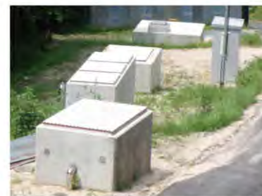
下り茅水道の小規模浄水施設
