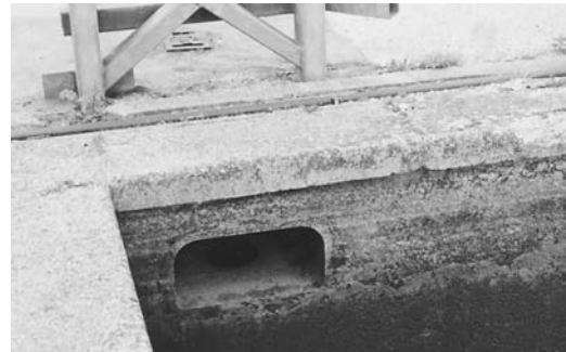
図 82. テムズ水道のろ過池では、越流管でなく、壁面の穴からスカムを排出させるようにしていた。
