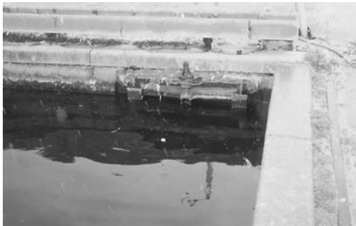
図 83. 越流口は、必要ない時は、蓋をしていた。スライドさせてスカムを排出させるようである。
