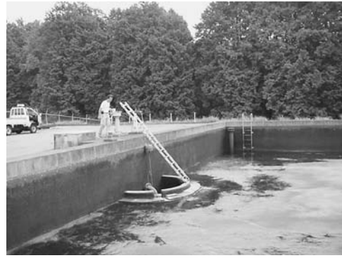
図 54. S 県には、1960 年代に建設した緩速ろ過施設があった。河川表流水を取水し、河川水が濁ると凝集剤を添加してから緩速ろ過処理をする。普通は、河川水は濁ることが少ないので、凝集剤を使用しないでも、長くろ過ができる。ろ過を開始すると糸状珪藻メロシラが繁殖するが、水深が深いので、水圧が高く気泡が生じにくい。そのため、剥離浮上しにくい。そのため、ろ過を続けると糸状緑藻に遷移しやすい。水深が深いので、糸状緑藻も水面に浮きにくく、連続培養状態になりにくかった。砂面の削り取り時に、この藻を取り除く作業が大変とのことである。
