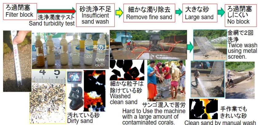
図 30-3 砂の洗浄不足でろ過閉塞していた⇒手作業の洗砂でもきれいになる Filter blog due to the insufficient sand wash ⇒ Clean sand by manual
