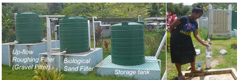
Fiji 村落給水装置 上向き粗ろ過、生物浄化砂槽、貯水槽、給水栓
